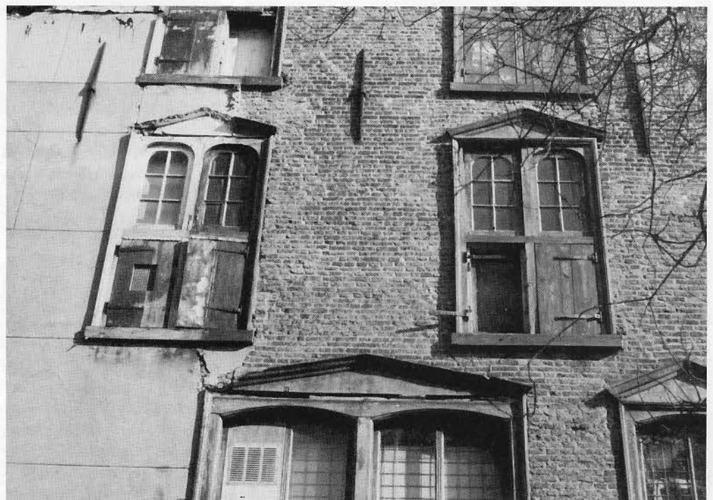
De voorgevel van dit gebouw is wereldberoemd als voorbeeld van vroeg-Renaissancebouw. Bij de sloop van het voormalige Hopgebouw ernaast kwam even de fraaie zijgevel in het zicht. Aan de achterzijde zien we een hele verzameling van 16e-eeuwse ramen, in dezelfde stijl dus als hun collega's aan de voorgevel. De wat vervallen achterkant van het oude St. Jansgasthuis, gezien vanaf het Glop, het straatje dat te bereiken is via de Lange Kerkstraat.
