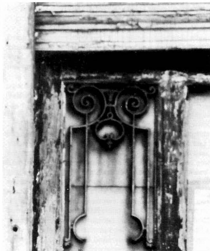
Achterom 2-4, ijzerwerk in de deur vóór de restauratie
